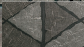
4320 ↑ジョイント部拡大写真
